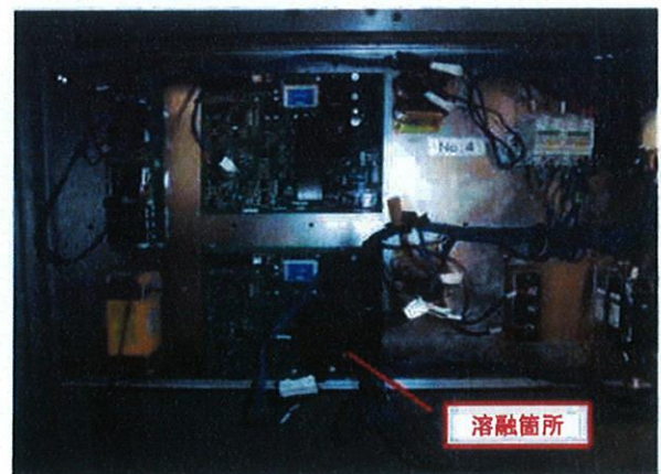
写真-2：EV制御盤内 基板溶融箇所
